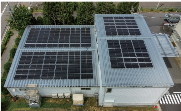
太陽光発電設備を導入したカワイ精密金属(株)松本事業所
